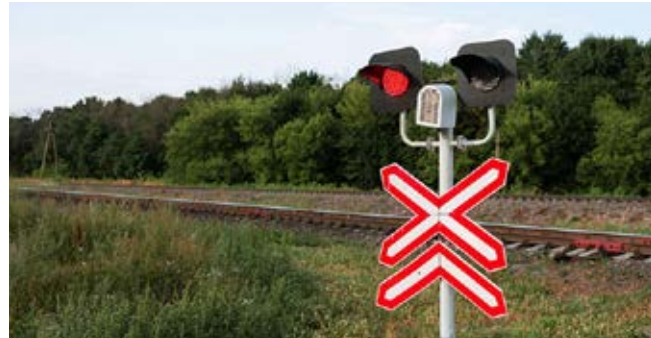
Ein WAVETRAIN-Signalmast an einem ländlichen Bahnübergang.
