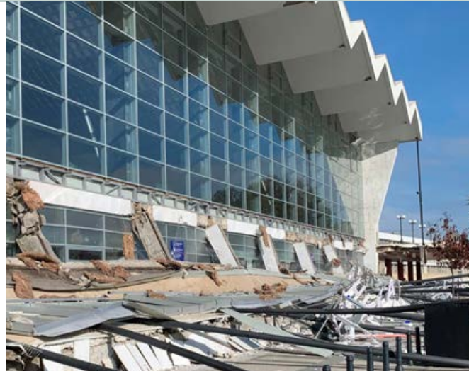
Ein Foto vom Tag des Einsturzes zeigt: Die Träger und die Streben wurden komplett aus der Verankerung gerissen.
