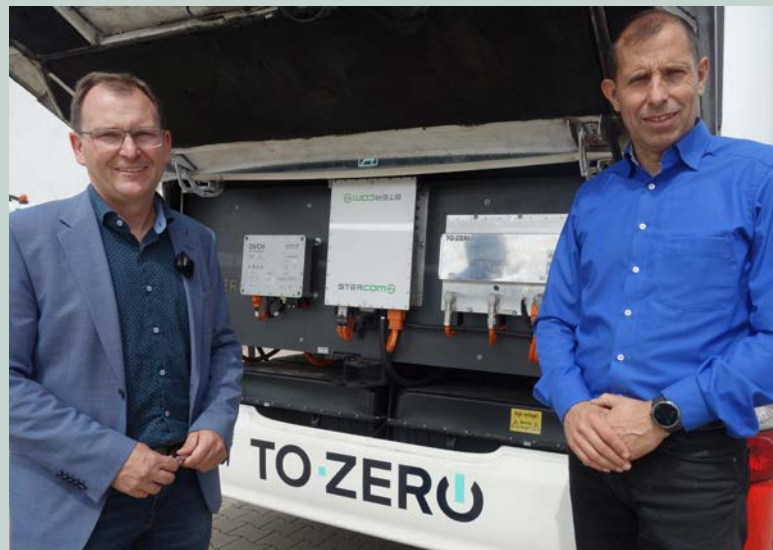
Alles handlich und übersichtlich: die Elektroausrüstung eines durch To Zero umgerüsteten Elektrobusses, hier mit den Geschäftsführern Hans-Georg Herb (links) und Andreas Pfeffer.
