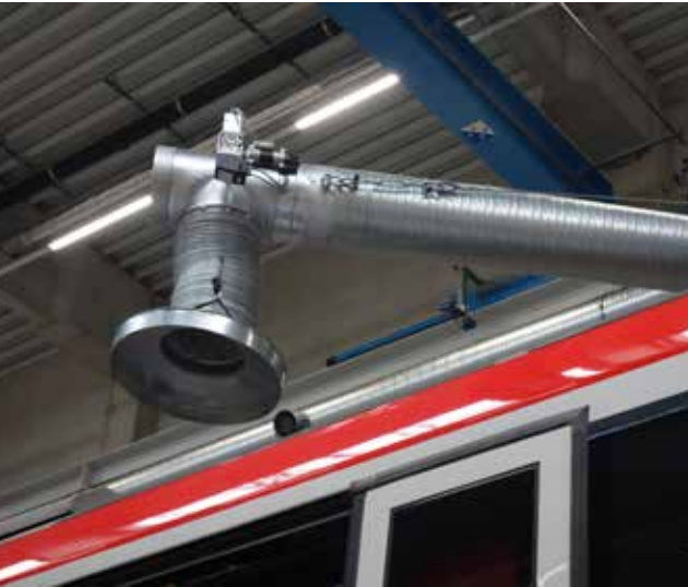
Keine Angst vorm Diesel – eine Abgas-Absauganlage am Standort Langweid. No fear of diesel – an exhaust gas extraction system at the Langweid site.
